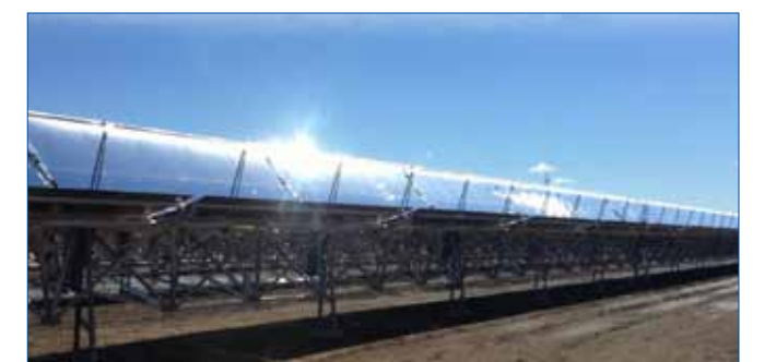
太阳能光热电站系统
