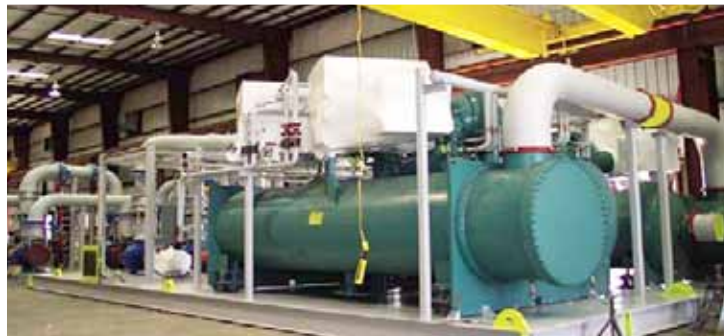
高效集成冷冻站（中央空调高效节能冷热源系统）
